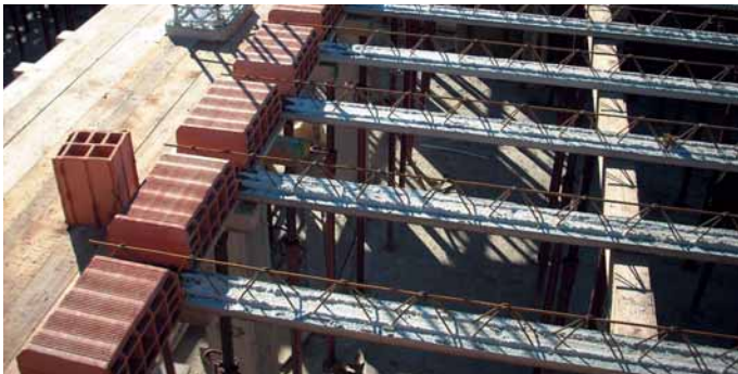
Posa in opera dei blocchi in un solaio: la presenza di vuoti può essere causa di cadute dall'alto.
